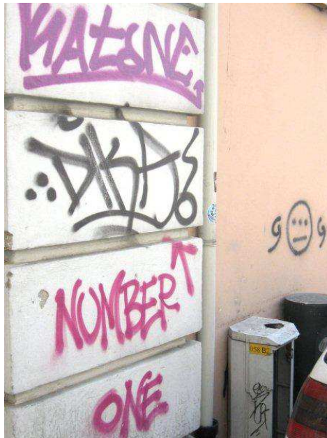
Prima dell'intervento_Corte dei Conti
